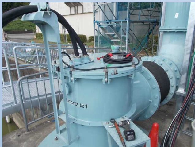
荒河排水機場のポンプ設備
