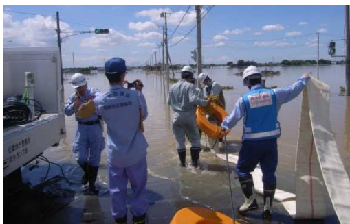
排水ポンプ車による排水作業【平成27年9月関東・東北豪雨】
