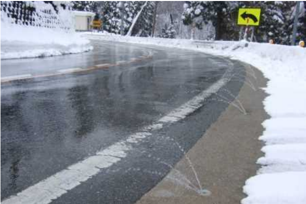
井戸水や河川水を散水し、道路上に積もった雪を融かす設備です。
